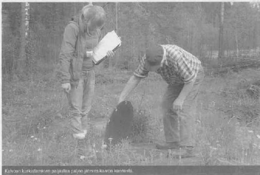
Kalvoon kurkistaminen paljastaa paljon jätevesikaivon kunnosta.
