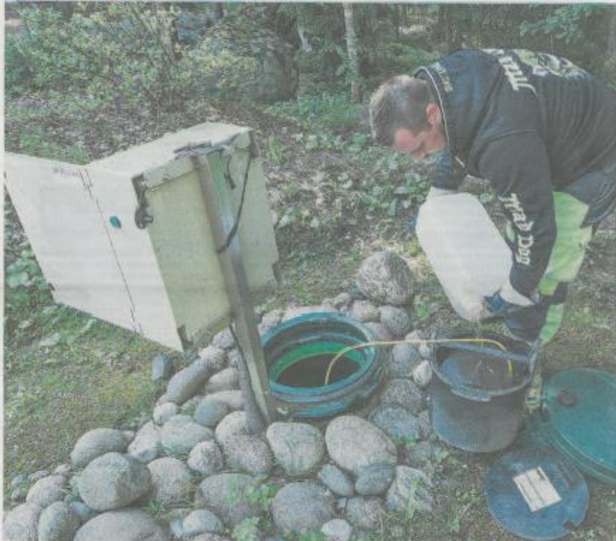
Pienpuhdistamon säännöllinen huolto takaa sen toimivuuden. Lisäksi on tärkeää, että jätevesijärjestelmä on mitoitettu oikein kiinteistön tarpeisiin.
