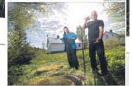
Kokemäenjoen vesistövesineuvontaa ja jätevesineuvoja Seija Nissinen huomauttavat, että saostuskaivon ylin rengas on likahtanut.
