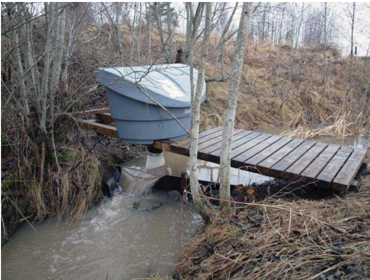
Kuva 3.4. Tammikuussa 2014 rakennettu Ferix-asema valmiina kemikaalinsyöttöä varten.
