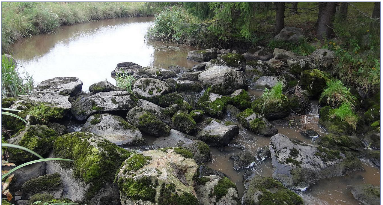
Kuva 2.54. Honkankosken niska-alueella sijaitseva kynnys, joka estää kalojen vapaan liikkumisen alivirtaamakausilla.
