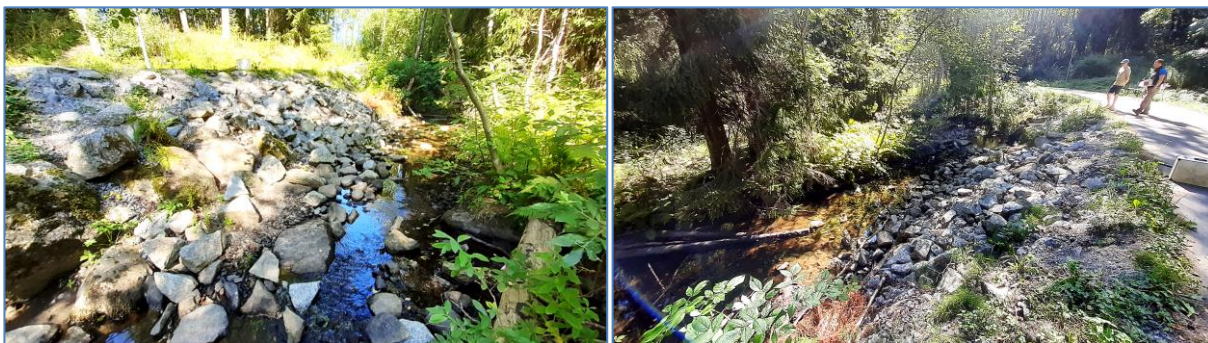
Kevyen liikenteen väylän jyrkkä kalliomurske penkka oli sortunut ja kalliolouhosta oli valunut uomaan.
