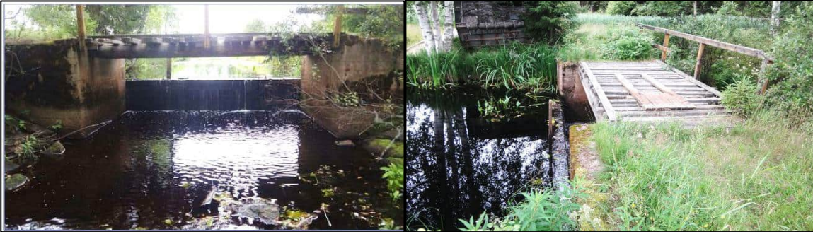
Kuva 4.3 Samminjoen luusuassa oleva pohjapato, joka määrittää Lavasjärven vedenpinnan korkeuden ja estää samalla kalojen vapaan liikkumisen. Lähde: raportti Rynkäjoen ja Samminjoen virtavesi-inventointi ja sähkökoekalastus 2017).
